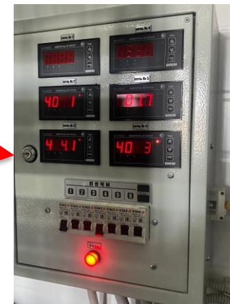
Рисунок 14 – Шкаф управления печами дополнительного подогрева
