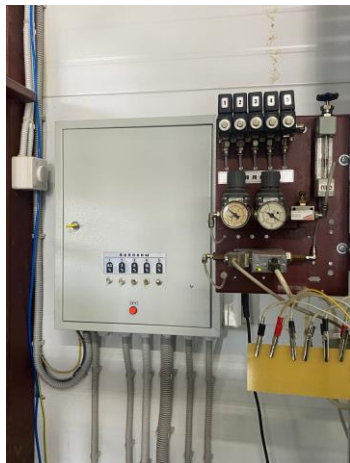
Рисунок 13 – Шкаф управления пневматикой и сбора данных
